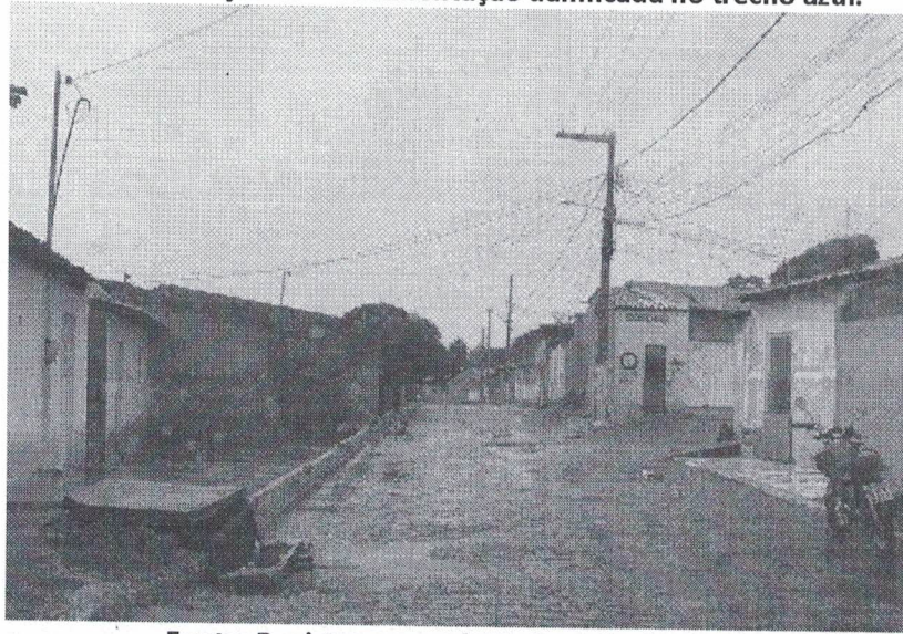
Ilustração 05 – Pavimentação danificada no trecho azul.
